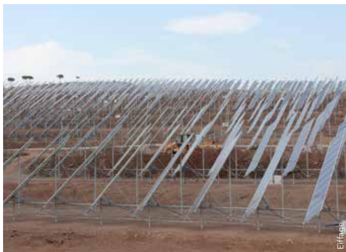
Champ de panneaux photovoltaïques à São de Julião do Tojal au Portugal (Eiffage Énergie).
